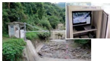
左：監視カメラと土石流センサーの設置 右：カメラ映像（桜島、鹿児島森林管理署）
